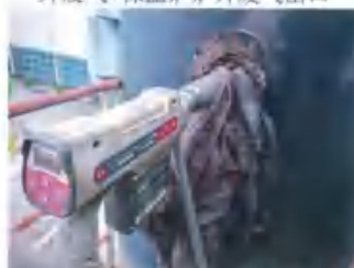
图 5 回转窑+冷灰桶排气筒出口
