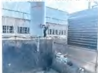
图 10 炒渣机+冷灰桶排气筒进口
